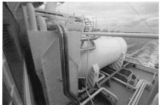
バイキンググレースのLNG燃料タンク
