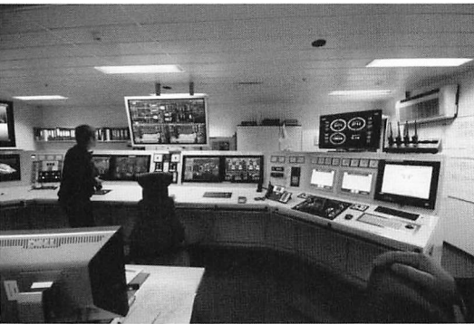
バイキンググレースのエンジンコントロール室
